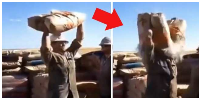
Imagem 01 – Rompimento do saco de cimento
