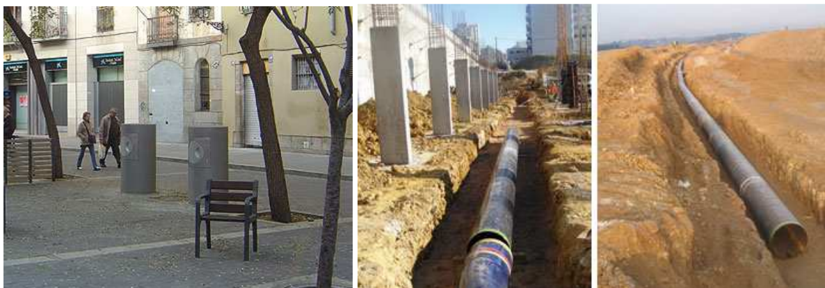
Figura 17 – Coletores de resíduos nas ruas de Barcelona e tubos de aço carbono por onde passam os lixos depositados nos coletores. Fonte: http://infraestruturaurbana.pini.com.br/solucoes-tecnicas/11/coleta-de-lixo-subterranea-e-a-vacuo-conheca-modelo-245157-1.aspx - Acesso em 14 de dezembro de 2015.
