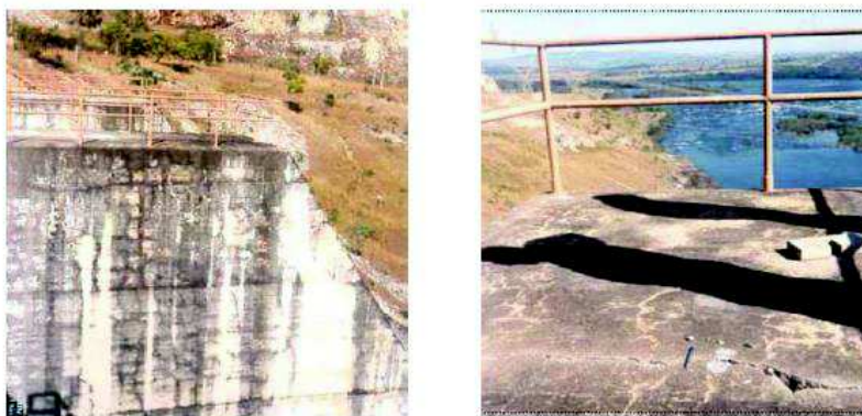
Figura 2 – Fissuras na face lateral e na seção transversal de um pilar de UHE Furnas.
