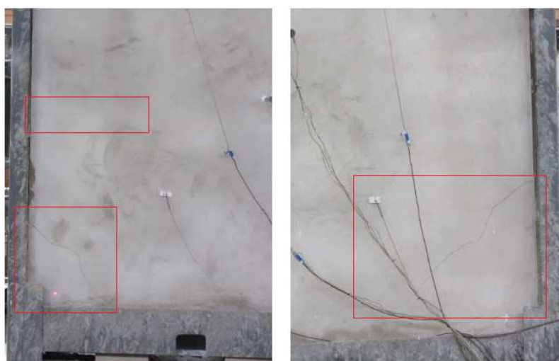
Figura 50 - Fissura horizontal e oblíqua
