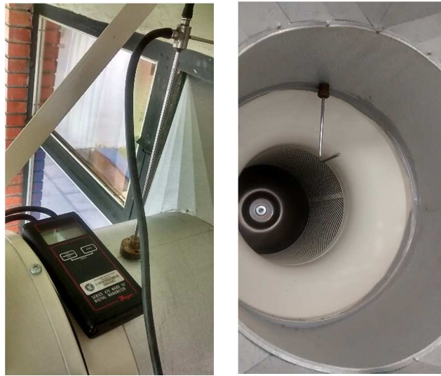
Figura 3.8 - Medição de pressão dinâmica do ventilador
