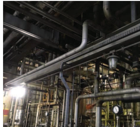
Foto 4 – lâmpada queimada, aguardando autorização para substituição.
