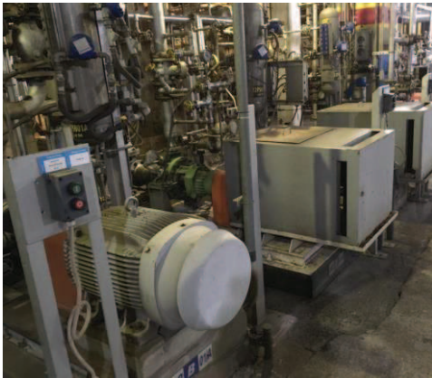
Foto 3 – equipamento com redução de ruído.
