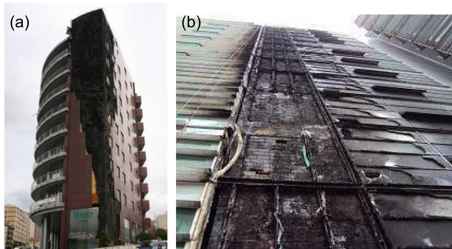
Figura 15 - Incêndio em edifício através da câmara ventilada (a e b)
