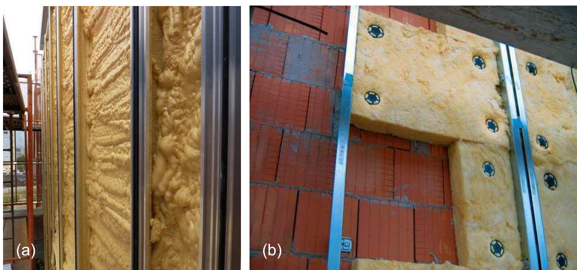
Figura 9 - Isolamento em poliuretano projetado (a) e painéis em lã de rocha (b)
