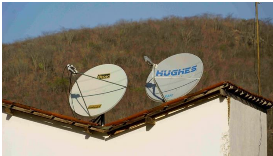
Fotografia 2 – Antenas instaladas no telhado da escola na comunidade
