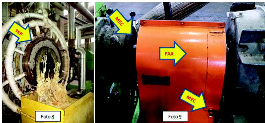
Figura 9 - Perigos identificados no granulador de polipropileno
